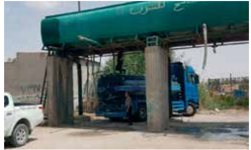
Privater Brunnen zum Befüllen eines Wassertankers mit dezentraler Entsalzungsanlage
